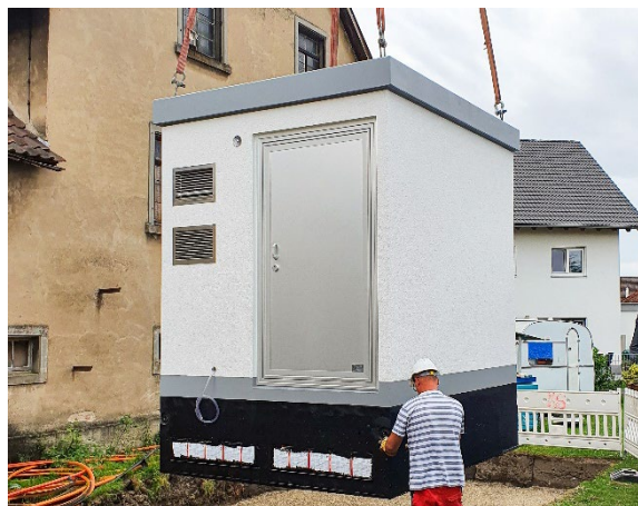
Das Herzstück des Breitbandausbaus in Unzhurst: Das Verteilergebäude (PoP) in der Achener Straße. (Foto Alexander Kern)
