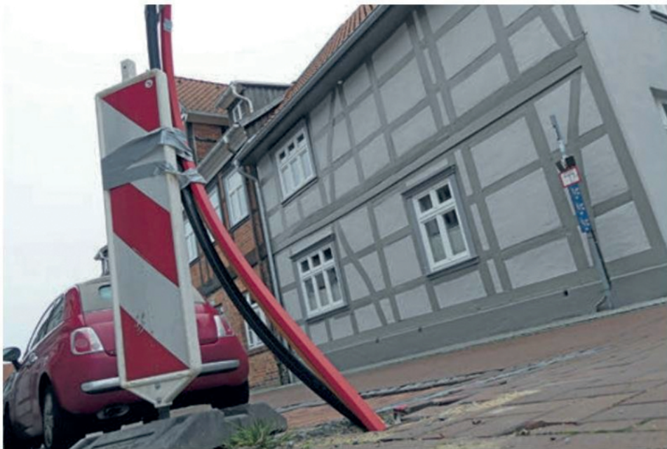
Auf der Zielgeraden: „Das bessere Netz“ beendet demnächst seine Anschlussarbeiten mit Glasfaser in Lüchow und wendet sich danach dem Folgeprojekt Wustrow zu.
